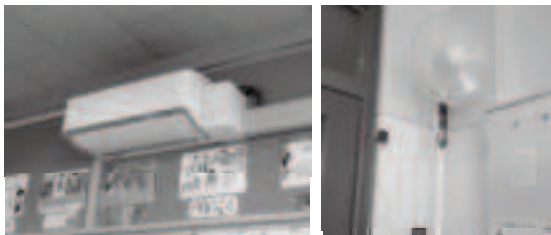
普通教室ではエアコンが設置されたが、エアコンを設置していない特別教室では室温を把握し扇風機などを活用している
