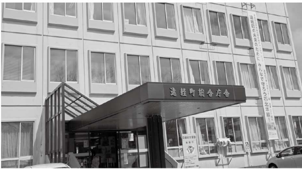
昭和47年に建設された役場庁舎は、耐震性能を満たしておらず、劣化状況も躯体、屋根、外壁、内壁のすべての項目でC判定とされた。
