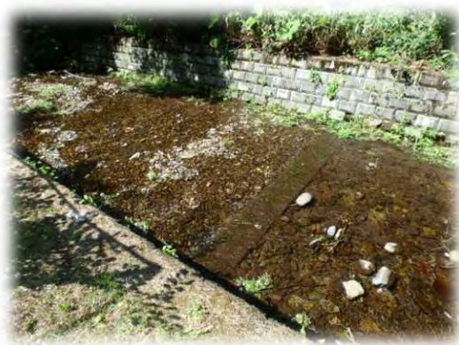
高橋沢川取水施設
