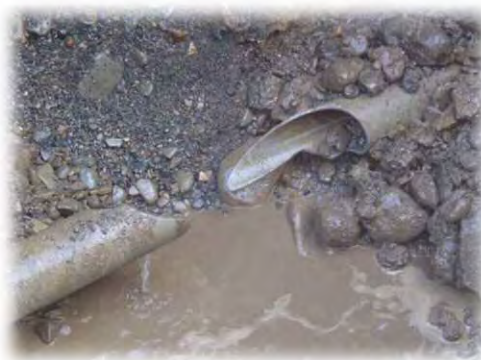
老朽化した水道管被害の例
