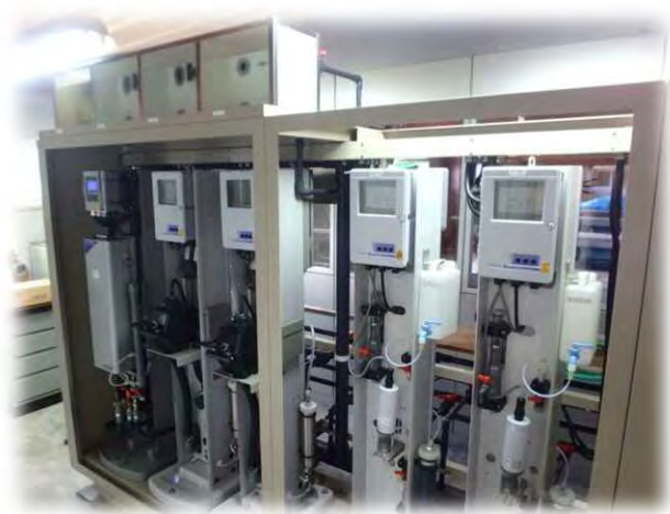
清川浄水場水質計器室
