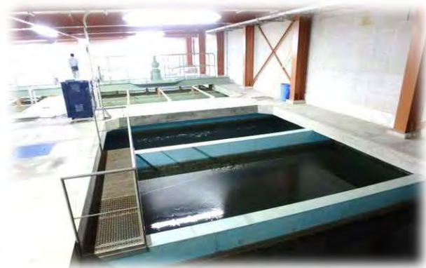
浄水処理施設
